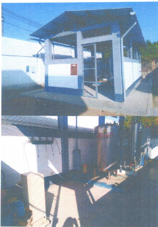
Instalación de planta generadora de Oxígeno medicinal gaseoso de 10m3 x hora, donada por la Municipalidad Provincial de Huarmey, para la atención de pacientes COVID, que requieran de oxígeno para su tratamiento y recuperación
